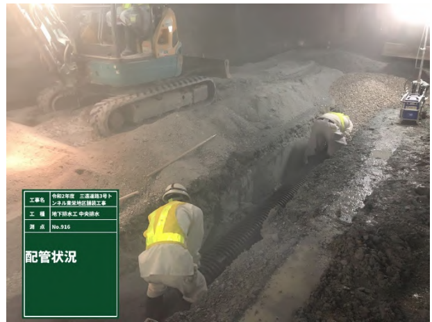
写真-4 配管状況
