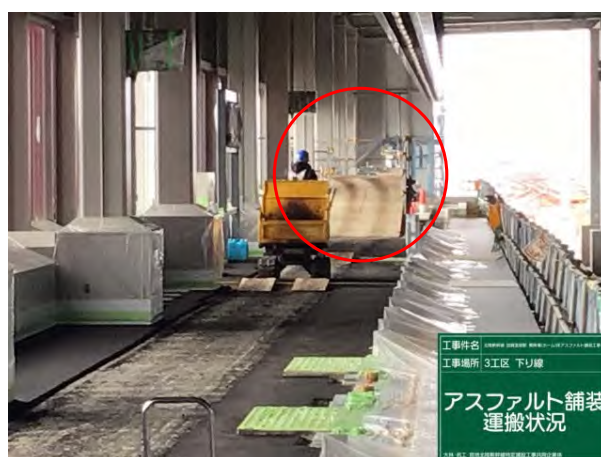
写真-2 高低差解消用仮設通路
