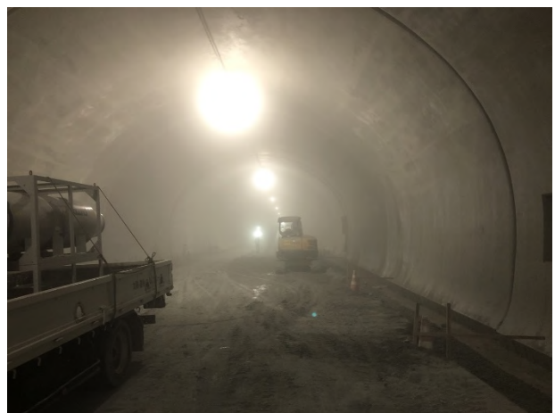
写真-5 坑内粉塵状況
