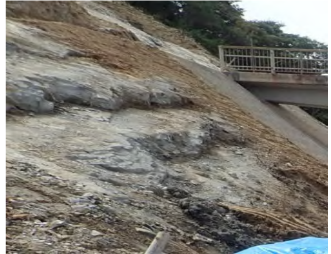
写真-1 岩盤すべり面(土砂撤去後)
