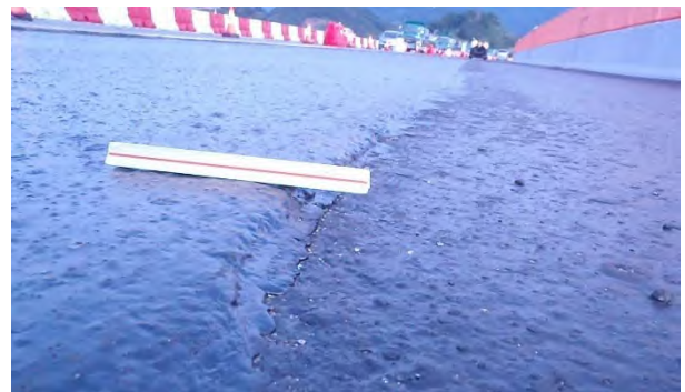
写真-5 施工継目部のダレによる段差発生状況
