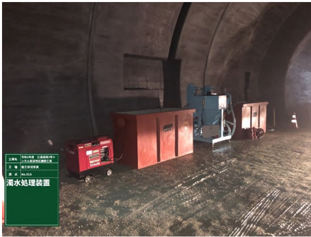
写真-7 簡易汚水処理施設
