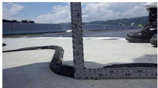
写真-1 伸縮装置の閉合による目地材の盛上がり
