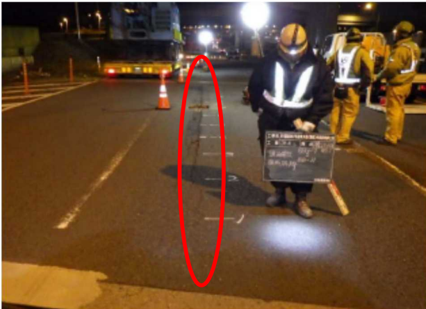
写真-2 縦断クラック発生状況
