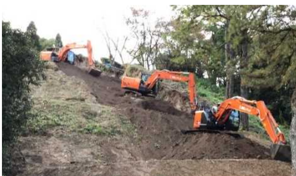
写真-9 崩壊土砂まくり上げ状況
