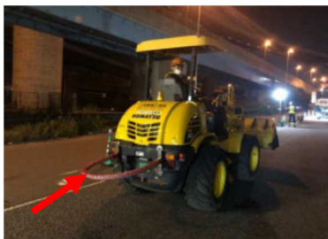
写真-16 タイヤショベルの接触防止装置
