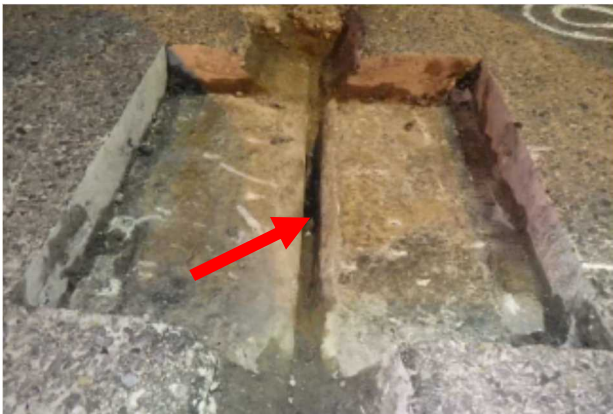
写真-3 開削によって判明したCo床版の縦ジョイント
