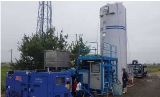
写真-1 JSGプラント設置状況
