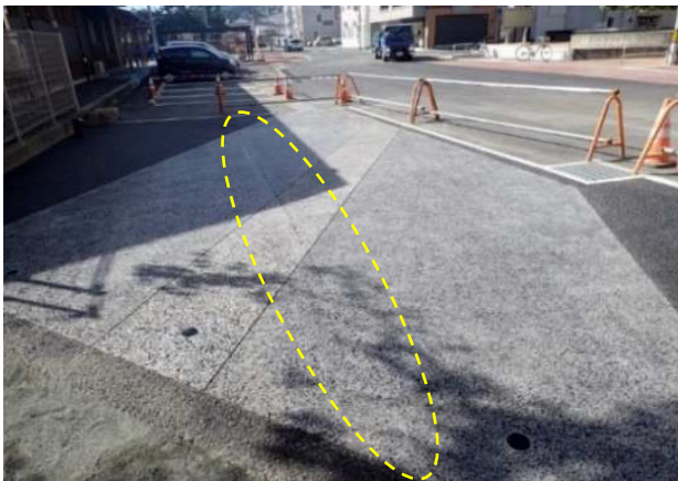
写真-4 施工目地の浮き
