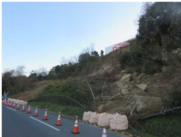
写真-1 2017年9月の台風18号で崩壊した法面
