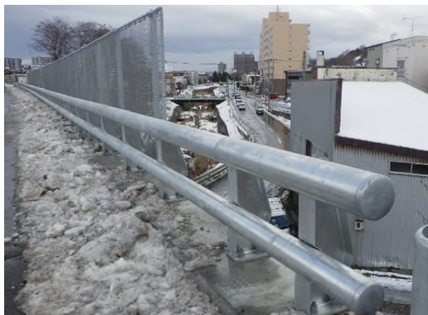
写真-8 鋼製高欄塗装変性前
