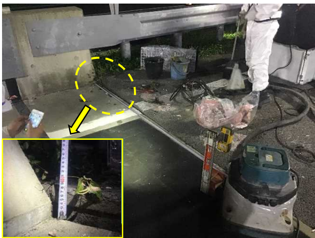
写真-7 隆起した舗装版
