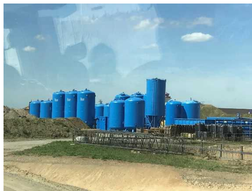
写真-31 地下水浄化装置
