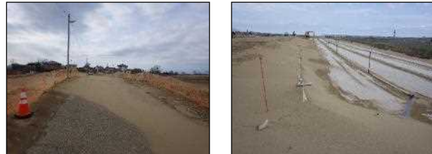
写真-2 飛砂発生状況および飛砂被害状況
