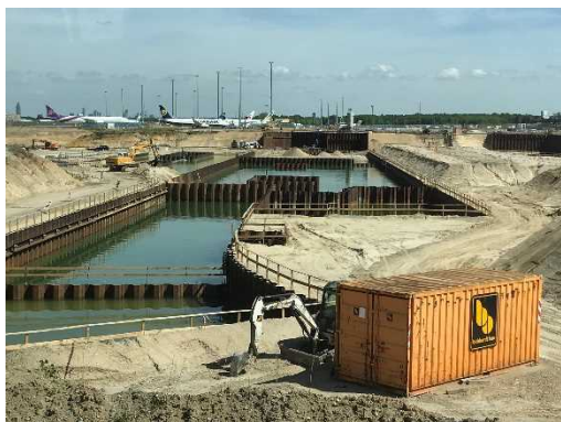
写真-30 地下水貯蔵エリア(-18m)
