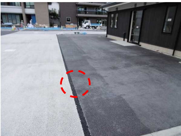
写真-4 路面標示位置における未充填部
