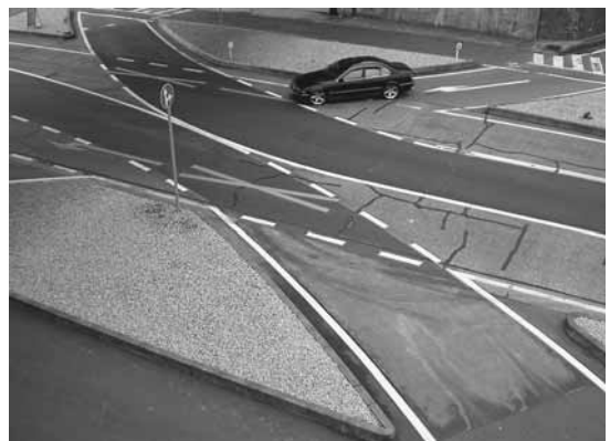
写真-2 施工直後（右下：白華発生）
