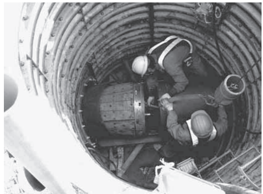
写真-1 EXP-500Rの設置状況
