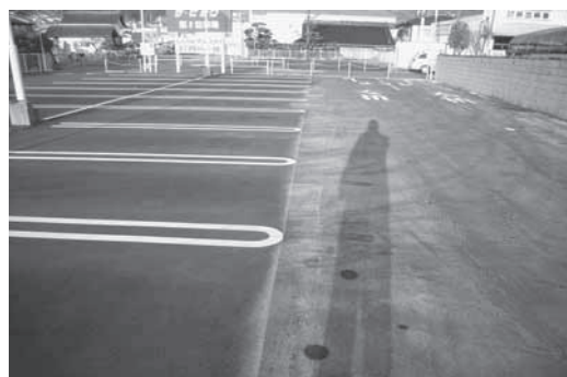
写真－9 白華発生状況
