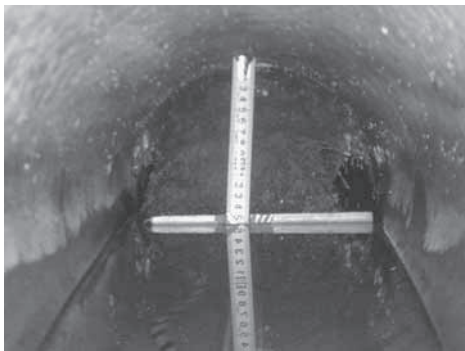
写真-6 施工前状況 管継手部より木根侵入状況
