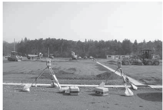
写真-6 設置状況
