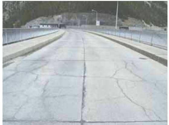
写真-4 管理用道路 コンクリート破損状況
