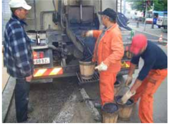
写真-12 歩道用グースの施工 クッカー車から木製樽に取る。
