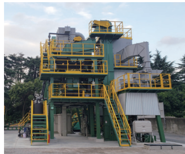
新設した研究開発専用プラント
