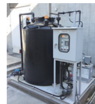
技術研究所に設置されている中和槽
