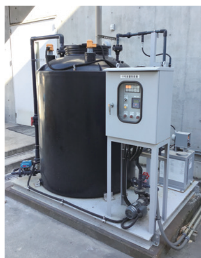
技術研究所に設置されている中和槽
