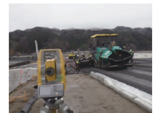
施工日数短縮によりCO 2 排出量削減へつながるICT舗装
