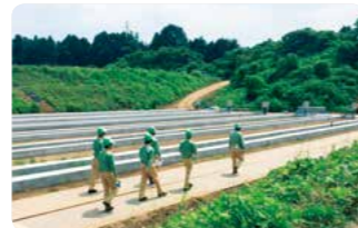
太陽光発電現場
