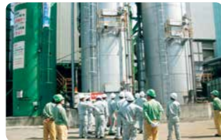
アスファルトプラント
