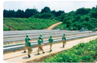
太陽光発電現場
