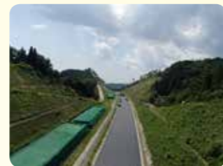
前田川橋～上羽鳥橋 加熱アスファルト安定処理路盤工 8月下旬
