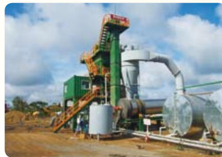
アスファルトプラント
