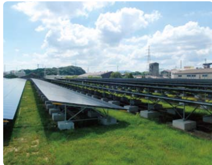
極東開発工業株式会社福岡工場発電所 (福岡県)
