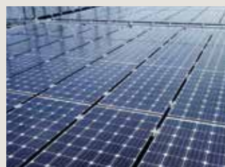
太陽光発電システム
