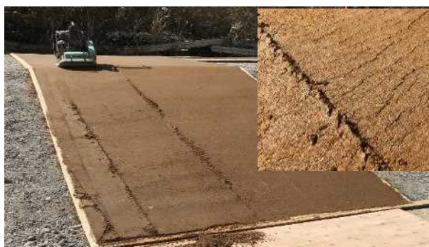
写真-3 転圧面の亀裂・試料の剥落
