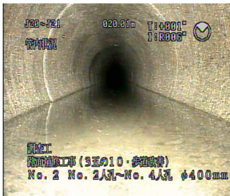
写真-4 本管帯水状況
