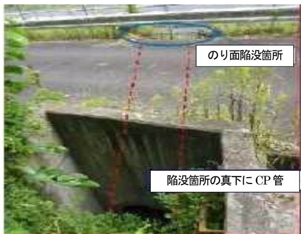
写真-1 陥没箇所
