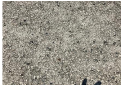
写真-3 D1 の路面の粗れ
