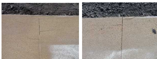
写真-6 目地部の不具合
