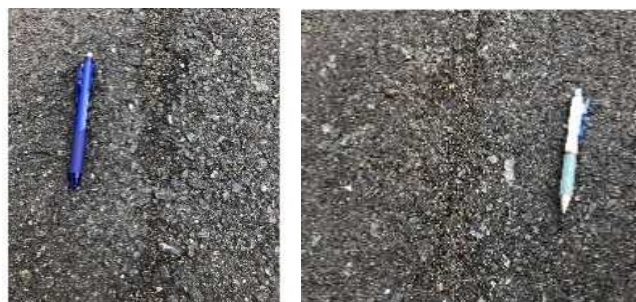
写真-1 施工継目の開きの例
