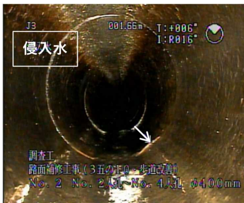
写真-3 本管侵入水状況
