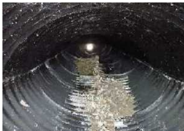
写真-3 既設コルゲートパイプの変形
