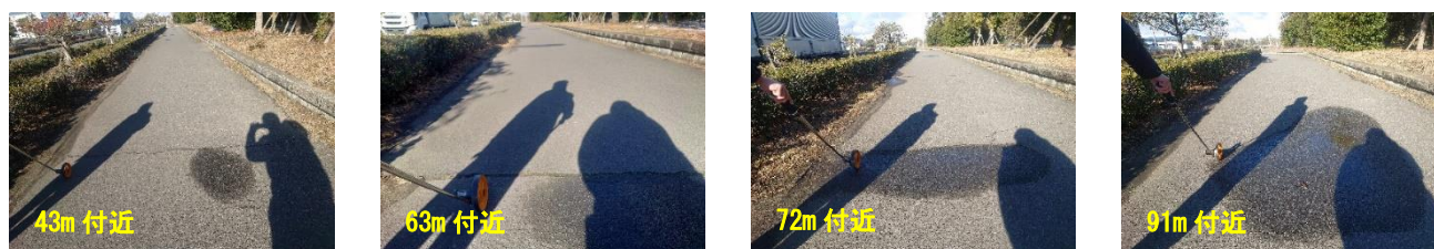
図-6 水溜まり発生状況
