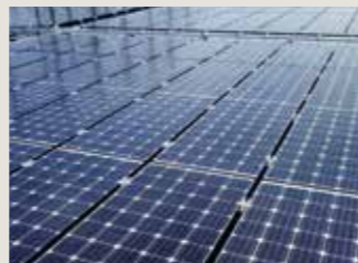
太陽光発電システム
