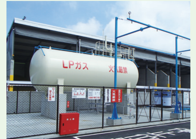
東条プラント LPガスタンク
