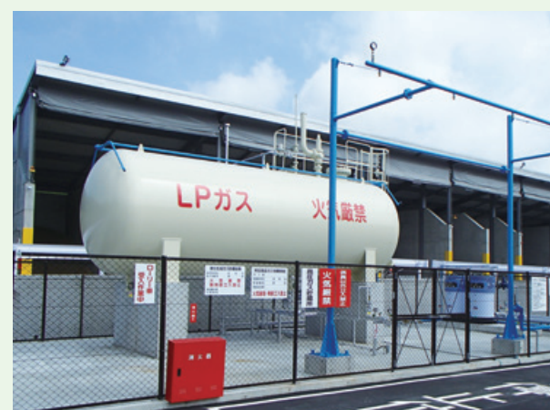
東条プラント LPガスタンク
