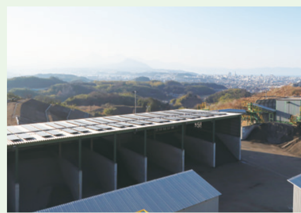
大分プラント 太陽光パネル
